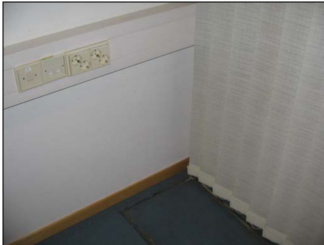
Figur 24: Kabelkanal i plast i kontorbygg
