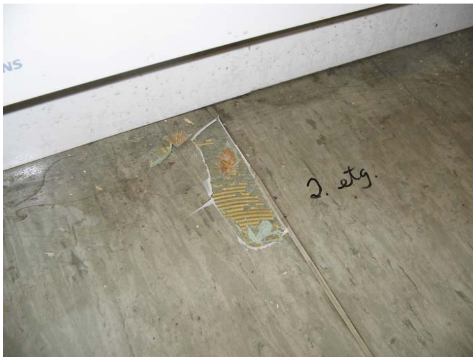
Figur 12: Vinyl gulvbelegg (Belegget på bildet har DEHP = 53.000 mg/kg, og er farlig avfall.)
