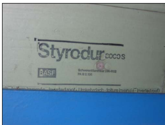
Figur 3: XPS-plate under kjørerampe i parkeringshus fra 1980-tallet.
