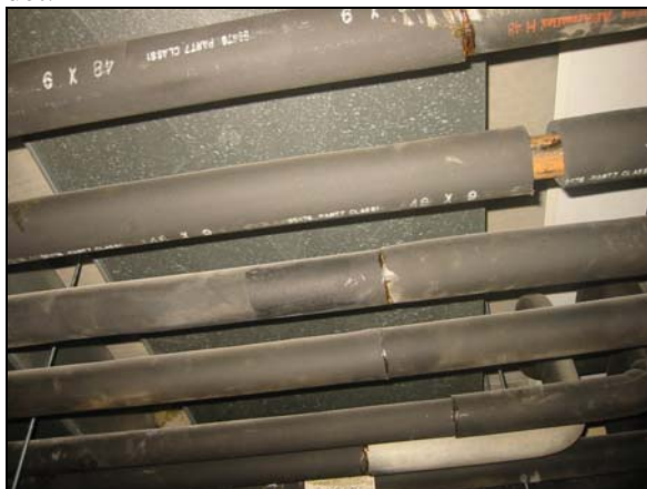
Figur 9: Cellegummiisolasjon på rør
