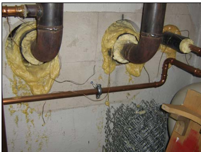
Figur 6: Fjernvarmerør gjennom yttervegg. Rørene har (lysegul) PUR-isolasjon fra fabrikk. Her er det også brukt (mørkegul) PUR fugeskum mellom rør og betongvegg.
